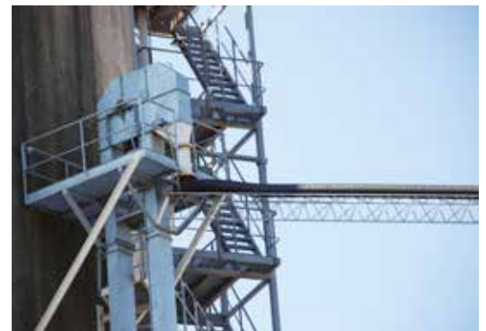
Cimenterie Scirocco II connecté à un élévateur à godets.
