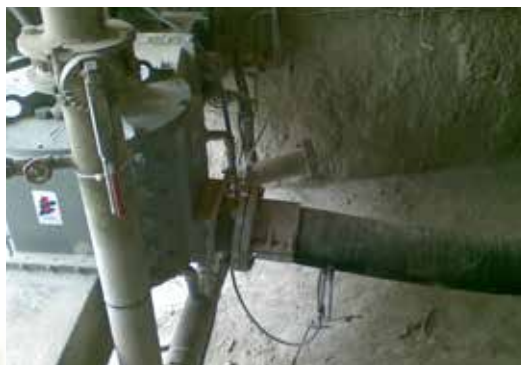
Cimenterie Connection d'un Scirocco II à une aéroglossière.
