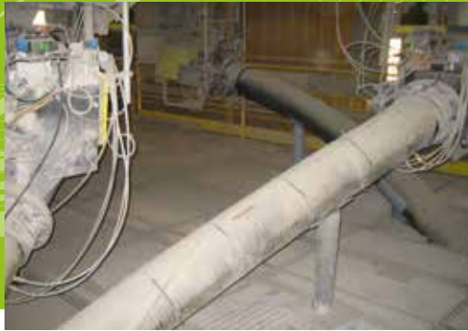
Cimenterie Scirocco II diamètre 10" (254 mm) pour chargement vrac de camions.
