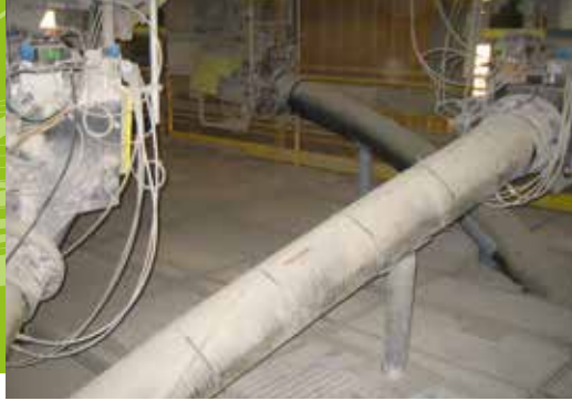
Zementwerk Scirocco II NW 10» (254 mm) für die Schüttgutbeladung von LKW's.
