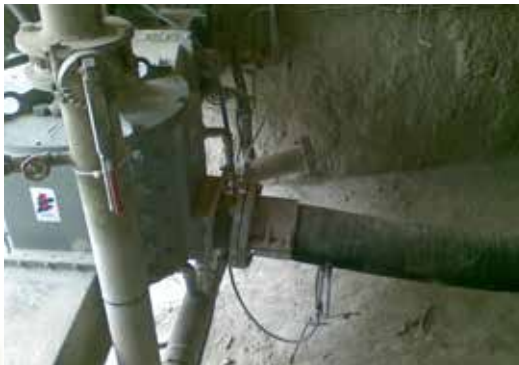
Zementwerk Scirocco II angeschlossen an eine traditionelle Luftrinne.
